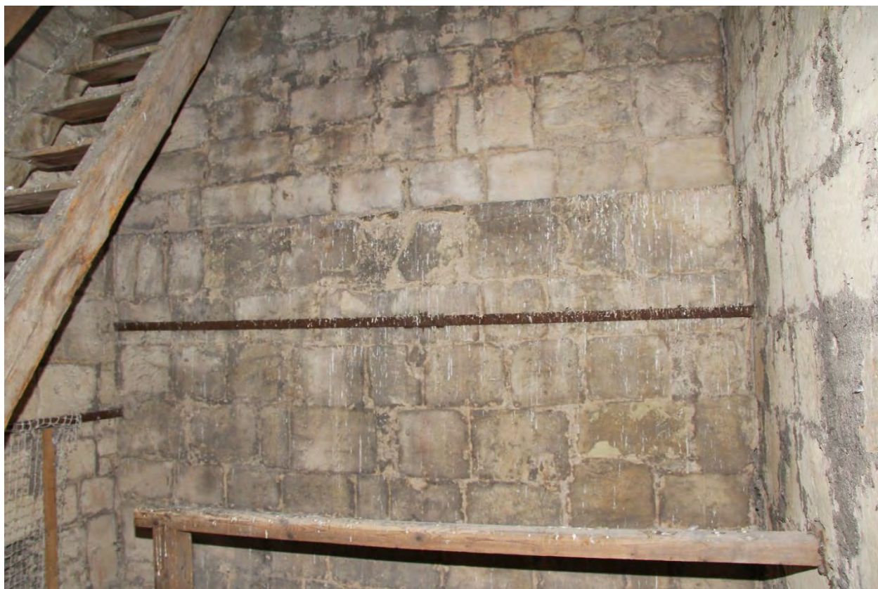
Západní strana druhého patra věže v pohledu od východu. Foto: Jaroslav Skopec, 2019.
