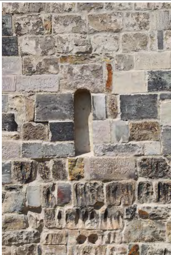
Jižní okenní otvor přízemí věže v pohledu od jihu. Foto: Marta Pavlíková, 2018.
