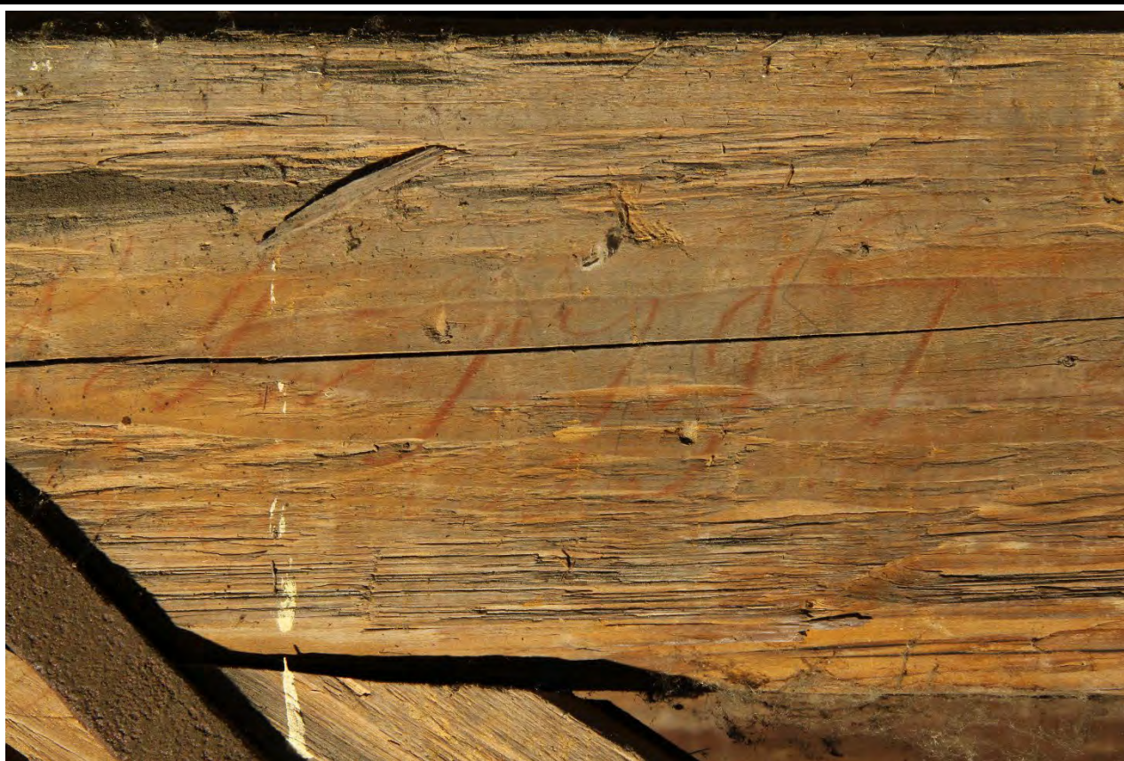
Detail rudkou psaného letopočtu na trámu krovu. Foto: Jaroslav Skopec, 2018.
